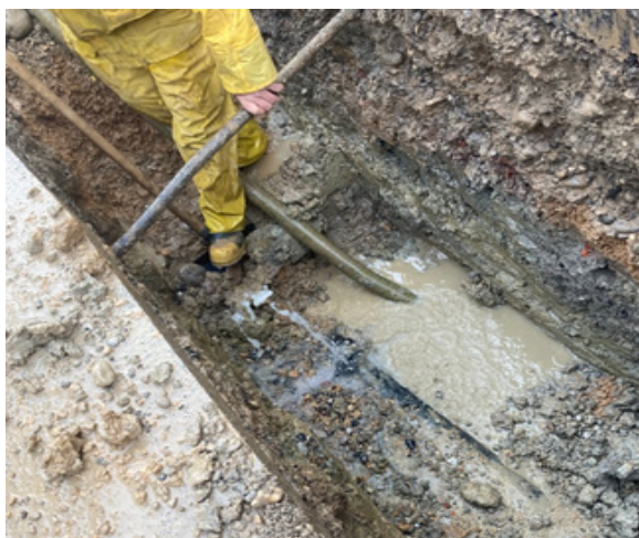
Leitungsbruchstelle «kleine Fontaine»
