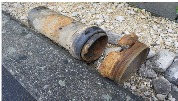
Gussleitung mit Schadensloch
