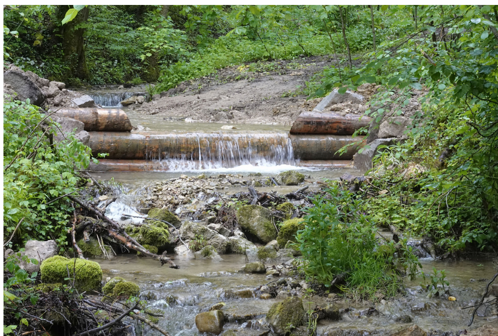
Das kantonale Tiefbauamt hat im Ämlisbach neue Schwellen eingebaut. (Photo: Thomas Mosimann)
