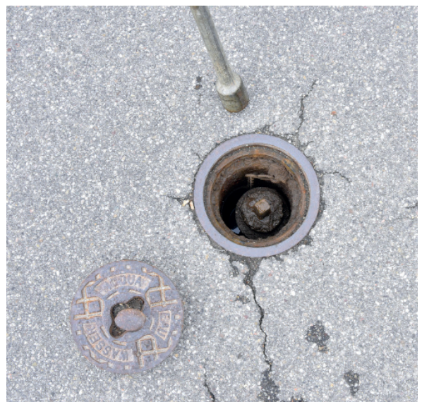
Schieber im Wasserleitungsnetz (Detail).
