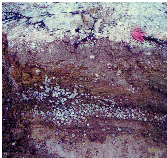
Alter Belag des Stoltenwegs. Unter der Teerschicht liegt ein Sand- und Steingemisch. Es gibt keinen Koffer.
