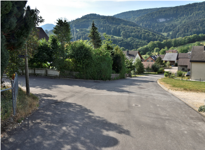
Eggweg und Abzweigung Rotshollen. Auf diesen Strassenabschnitten wurde 2016 und 2017 der Feinbelag eingebaut. (Photo: Gemeinde Lauwil)
