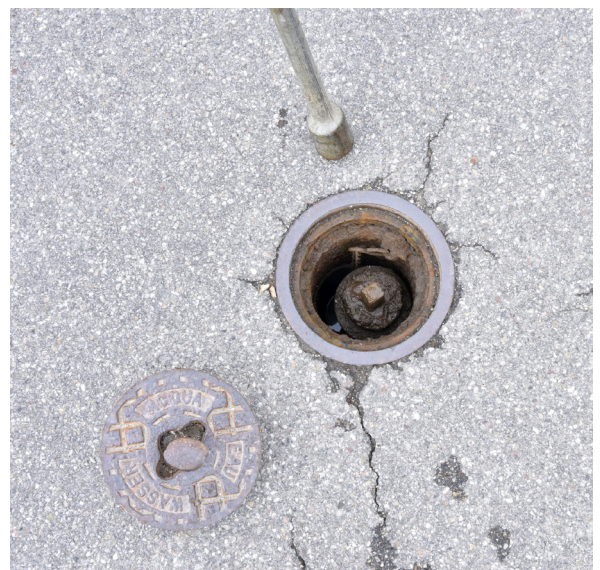
Schieber im Wasserleitungsnetz (Detail).
